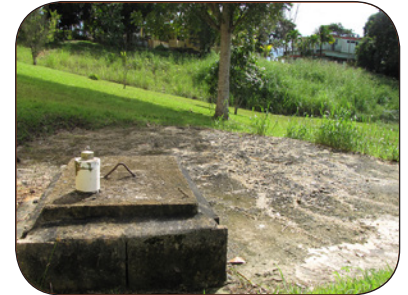
Mantenga el pozo séptico sellado.
